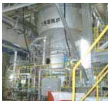
ガス化溶融炉
