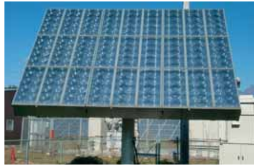
▲太陽光発電システム
