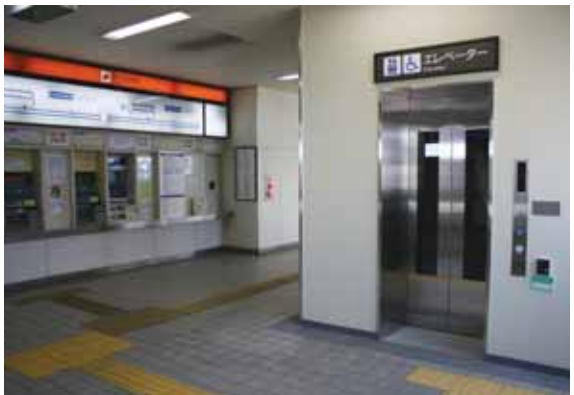
▲北出口「1階(地上階)～2階(改札口前)」エレベーター
