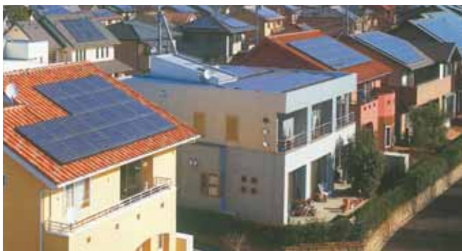
▲住宅用太陽光発電システム
