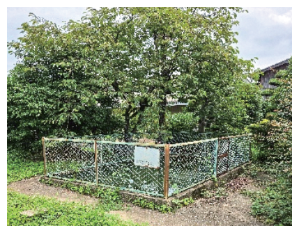
柵が老朽化した私設防火水槽
