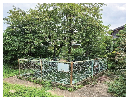
柵が老朽化した私設防火水槽
